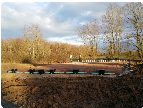
Filtre EnviroSeptic 100 EH installé en 2018
