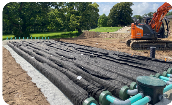
Filtre EnviroSeptic 60 EH en infiltration
