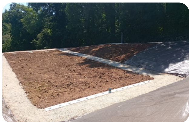
Filtre EnviroSeptic recouvert de terre végétale
