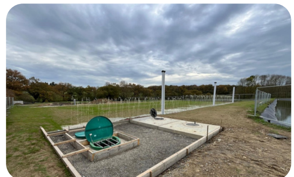
Test du système de répartition sous faible pression
